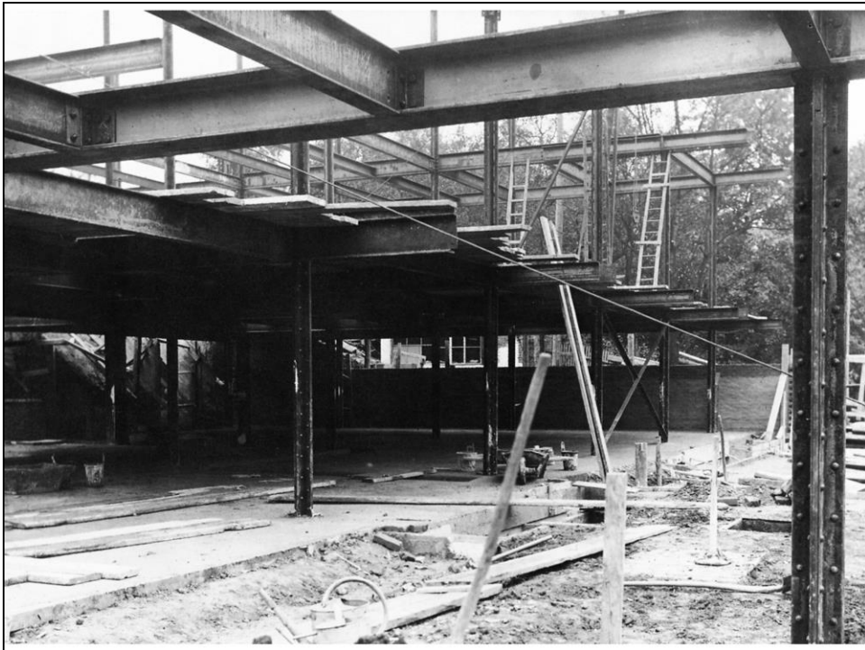
L. Mies van der Rohe, Casa Tugendhat, Brno (1928-30): la struttura in costruzione
