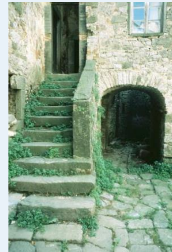
Degrado dei materiali
