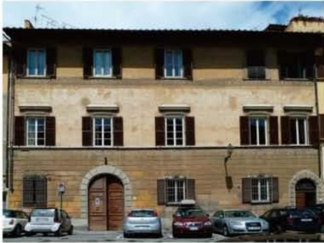
Degrado di facciate o parti di esse
