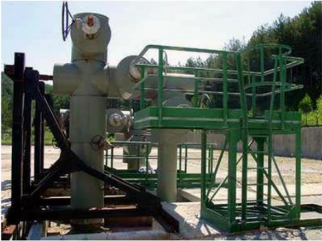
Pozzo di Produzione
