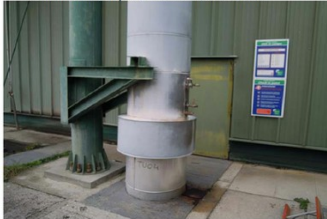
Collettore del vapore a monte della turbina
