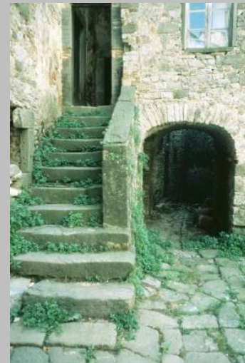
Degrado dei materiali
