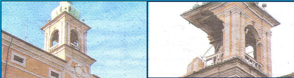
Torre campanaria del Municipio di Finale Emilia (MO), opera del Cinquecento, prima e dopo il sisma
