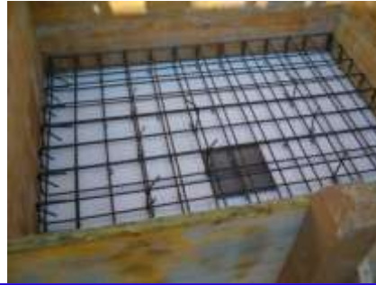
Vista dell'isolatore in acciaio-PTFE posizionato al disotto del vano ascensore, prima del getto della soletta intradossale dello stesso
