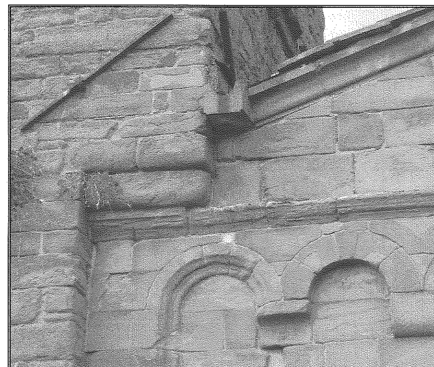
Fig. 8. Gropina, appoggio del campanile sulla navatella Sud visto da Est
