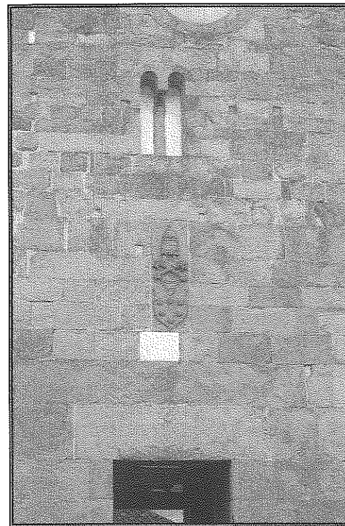
Fig. 12. Gropina, facciata, parte centrale sopra il portale con evidente disassamento
