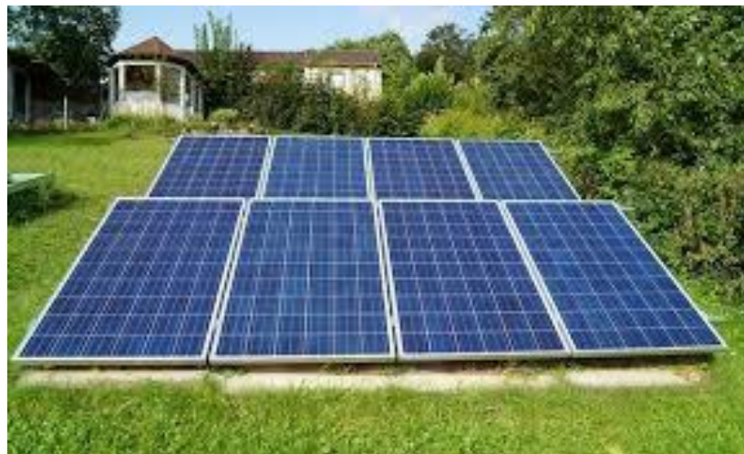
Impianto familiare a terra
