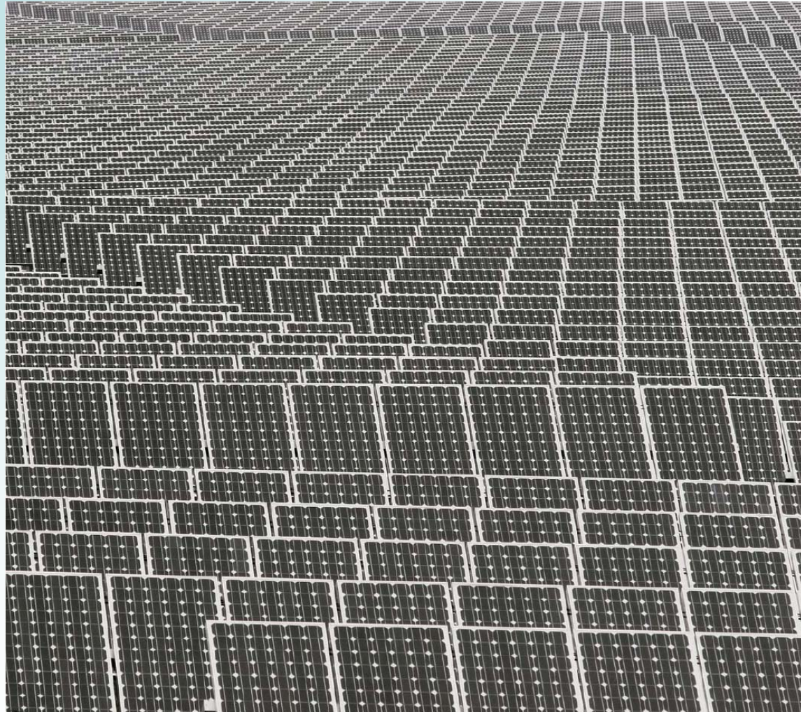
Impianto SERPA SOLAR da 11 MW, Alentejo, Portogallo
