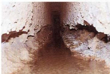
Foto 25 - Vistosi sgrottamenti lungo i fianchi del qanat di via Pindemonte.
