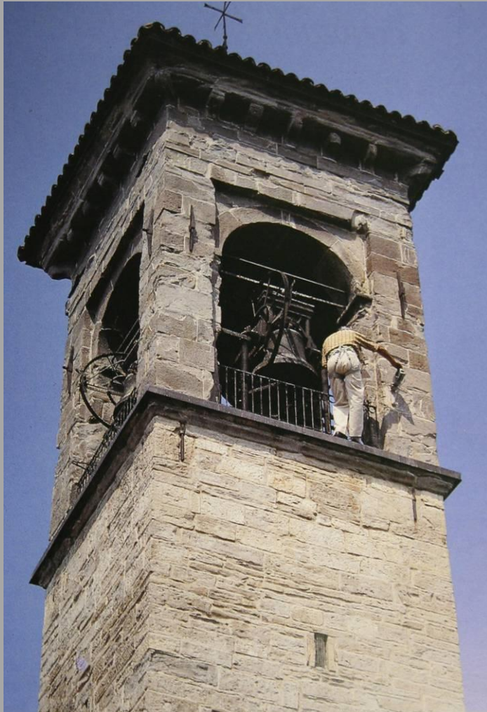
Installazione di clinometro (ISMES)
