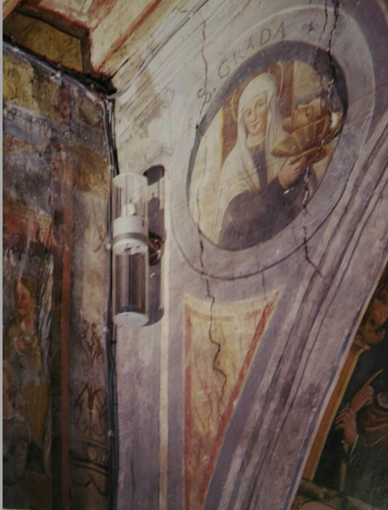
Misure dello spostamento relativo di due pareti
