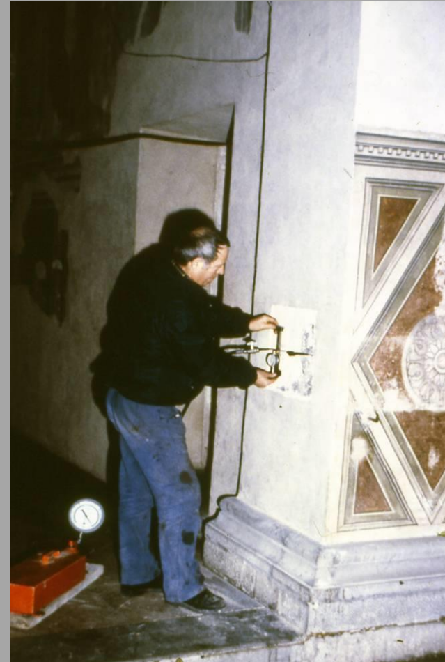
Lo studio delle murature della Cappella Maggiore di S. Francesco ad Arezzo, pilastro a cornu epistolae
