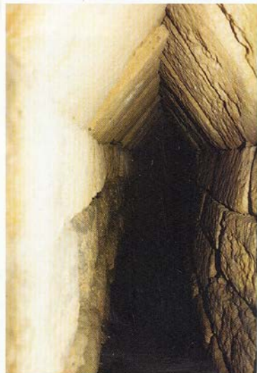
Foto 27/b - Tretto di qanat all'incrocio di corso Calatafimi con la Circonvallazione alla profondità di circa 10 m. La copertura è realizzata con lastroni calcarenitici posti a «bocca di fornace».
